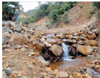
Absence de parafouille et début d'affouillement en pied
