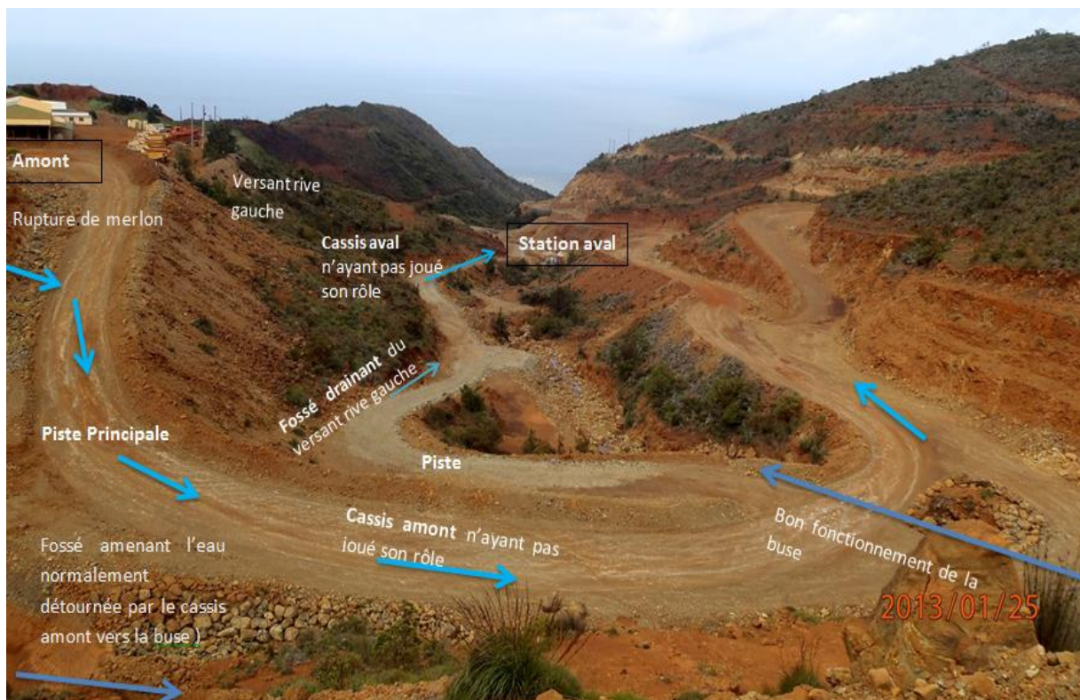
Figure 25 : dysfonctionnement des ouvrages de gestion des eaux sur le bassin versant de Poro lors de la crue du 24 décembre 2011, 25/01/2013
