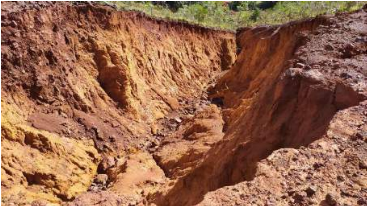
Photo nov. 2021 – tête de ravine vue depuis l’amont
