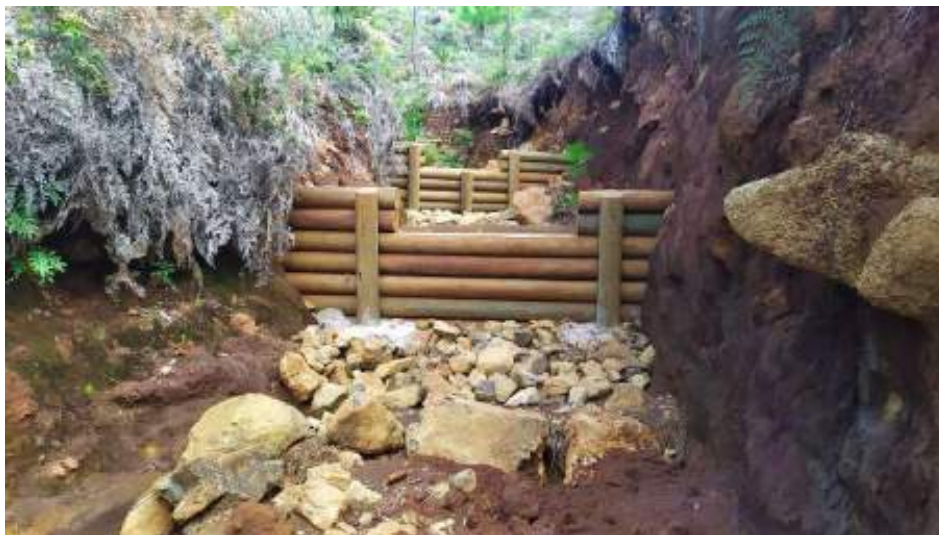
Figure 15 : Seuil en bois avec déversoir (Bel air)
