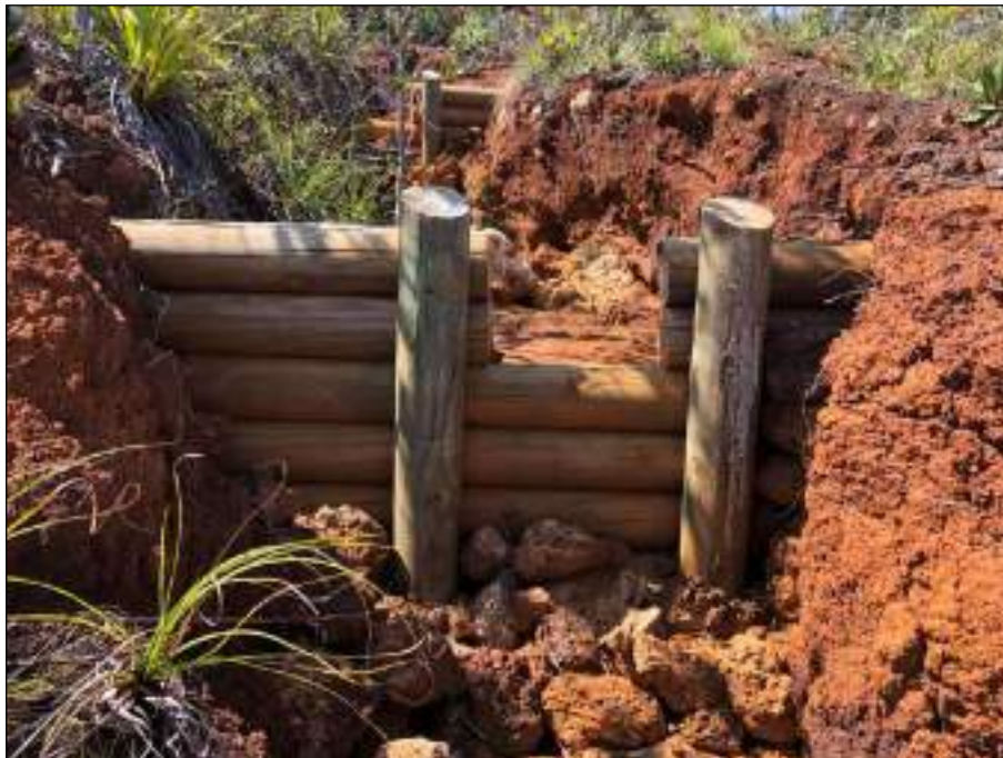
Figure 40 : Seuil n°6 dont le déversoir doit être effacé, Vulcain
