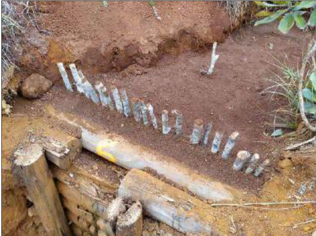
Seuil en bois (à simple paroi et sans déversoir) végétalisé (photo : Y. Crosaz)
