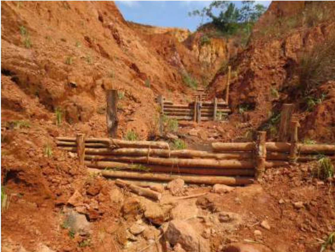
Interventions de génie écologique allié au génie civil dans des ravines en contexte minier en Guyane
